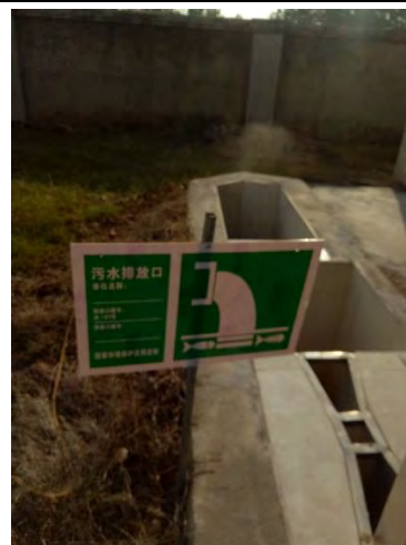
污水排放口标识
